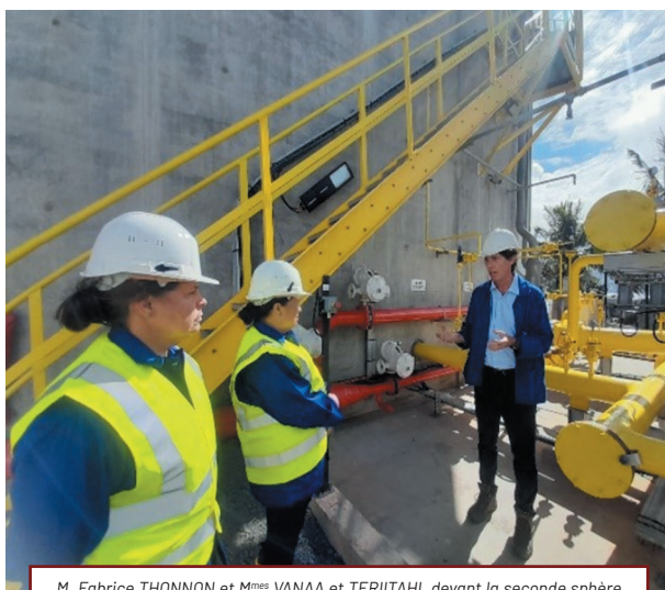
M. Fabrice THONNON et M mes VANAA et TERIITAHU, devant la seconde sphère sous talus pour hydrocarbures
